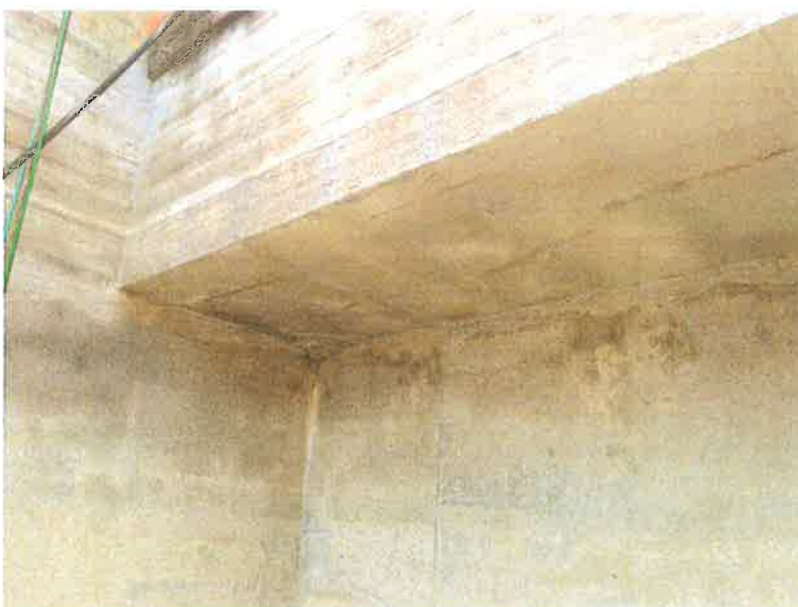
Odhalená korodující výztuž dna žlabu, který součástí nádrže
