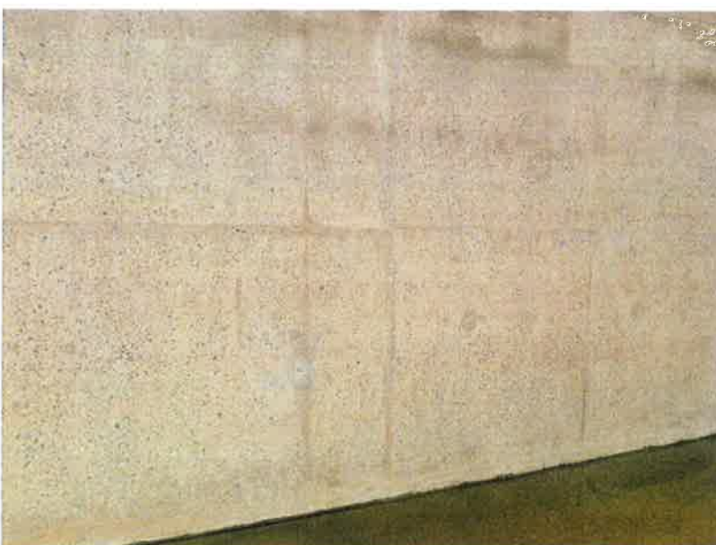
Degradace povrchu betonu stěny
