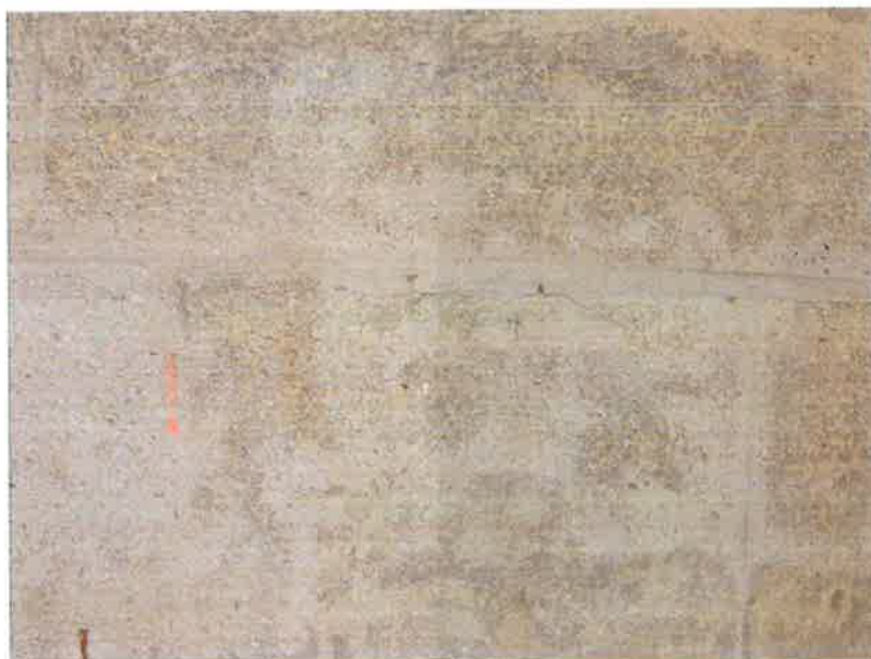
Degradace povrchu betonu stěny nádrže
