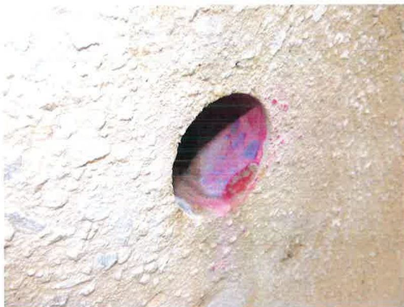
Pohled na otvor po odběru vzorku číslo 4 se zkouškou karbonatace betonu
