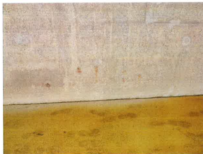
Degradace betonu stěny nádrže
