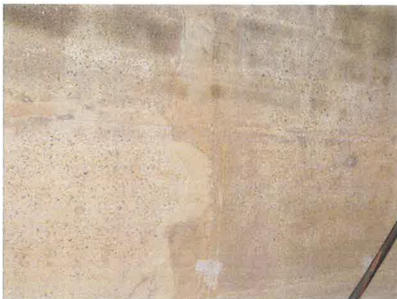
Pohled na degradaci povrchu betonu stěny nádrže
