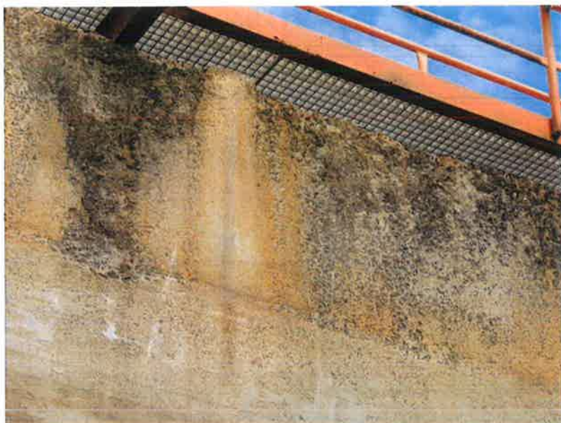
Detail degradace betonu v koruně stěny nádrže
