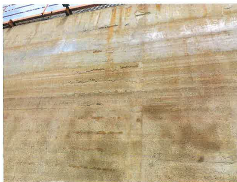
Odhalená korodující výztuž stěny nádrže
