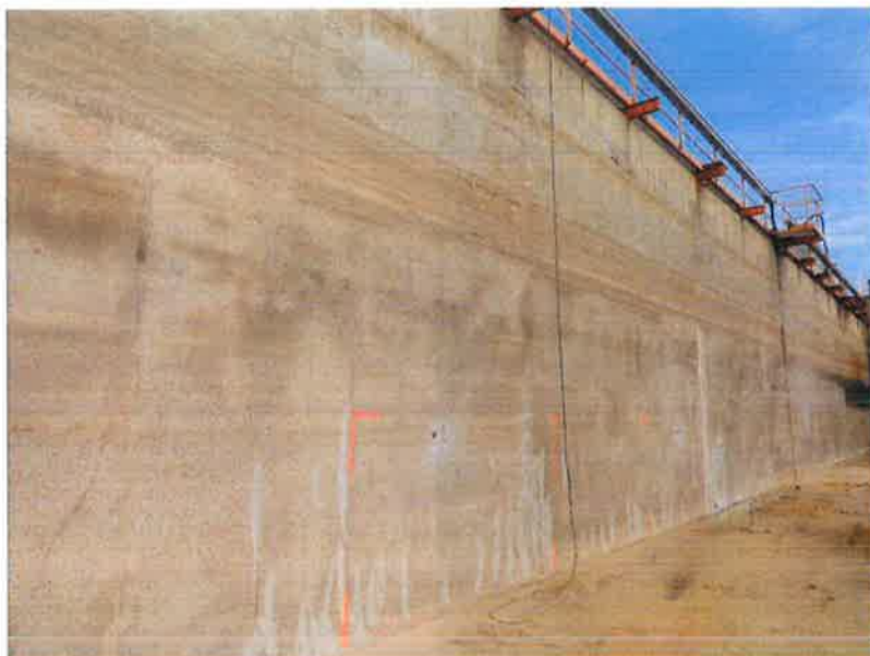
Pohled na další část stěny nádrže, odhalená výztuž, ošetřená výztuž a degradace povrchu betonu
