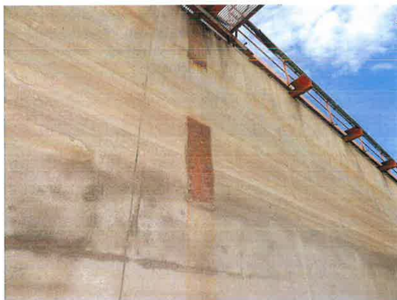
Degradace povrchu betonu, korozní zbytky na povrchu betonu pod odstraněnou konstrukcí
