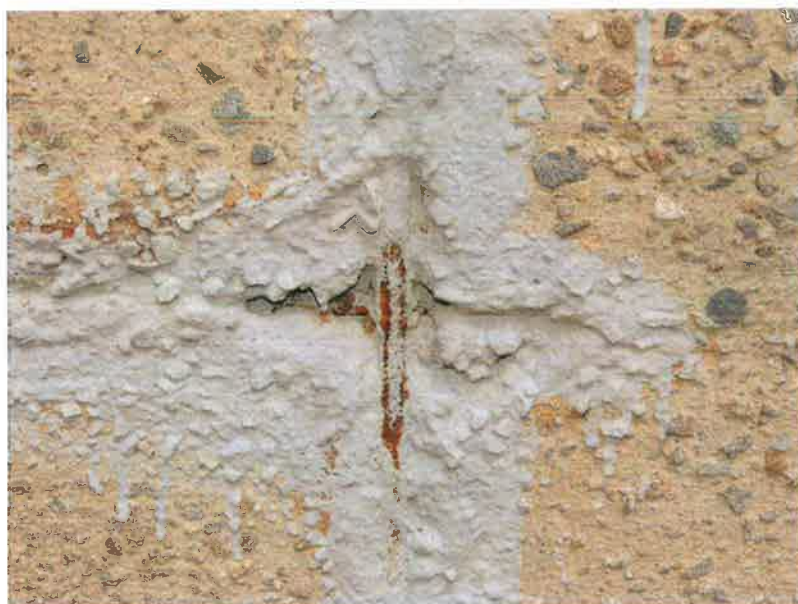
Odhalená korodující výztuž stěny nádrže
