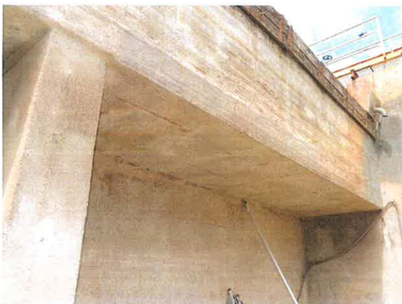
Odhalená korodující výztuž dna žlabu, který součástí nádrže
