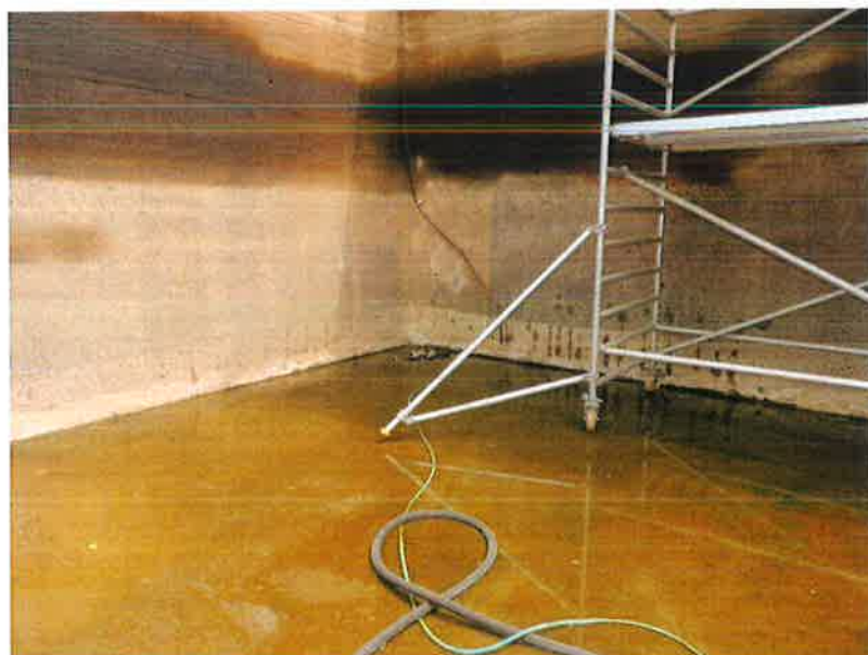
Pohled na část stěn s odhalenou korodující výztuží stěn
