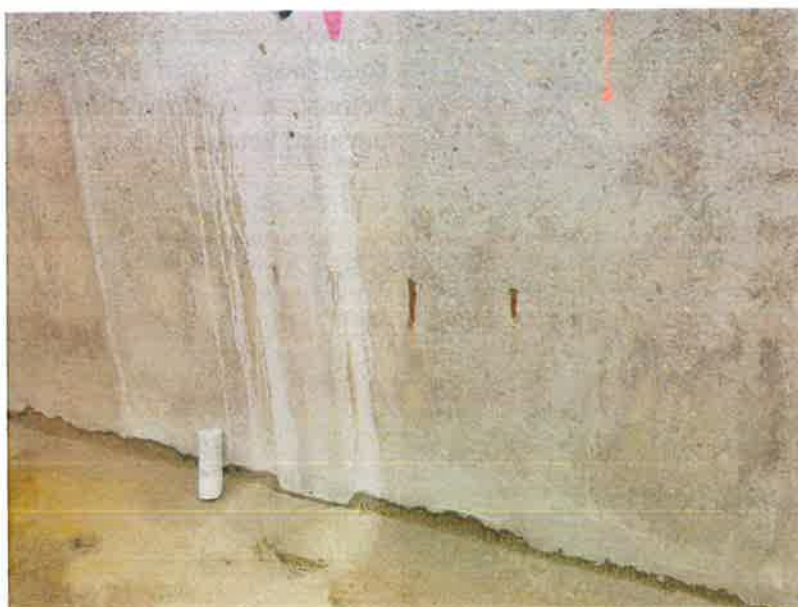
Odhalená korodující výztuž stěny nádrže
