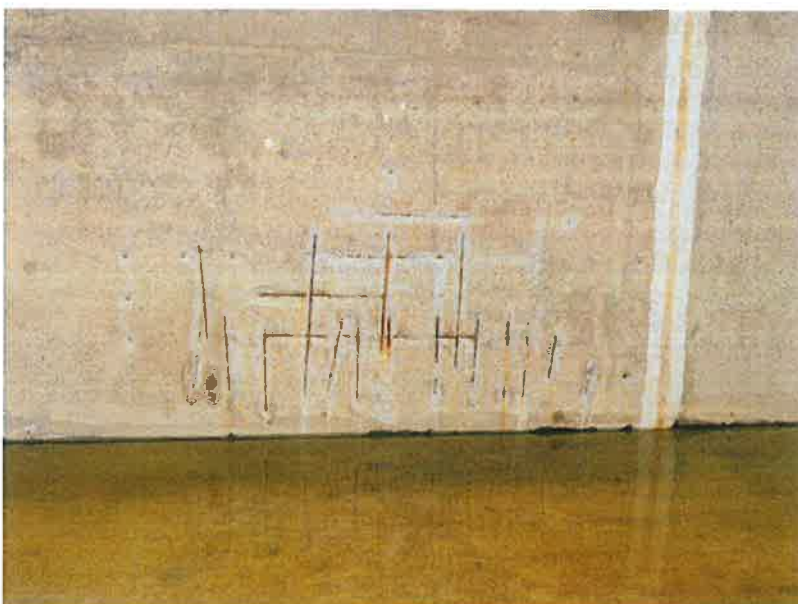
Detail odhalené korodující výztuže stěny nádrže
