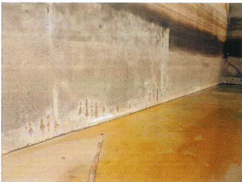
Pohled na část stěny nádrže s odhalenou korodující výztuží
