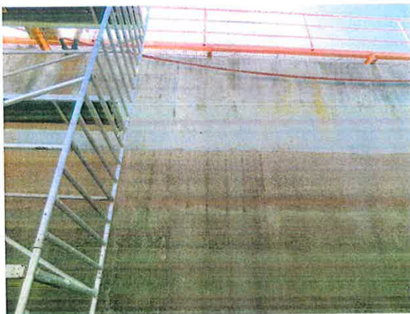
Viditelná koroze výztuže na povrchu betonu stěny nádrže
